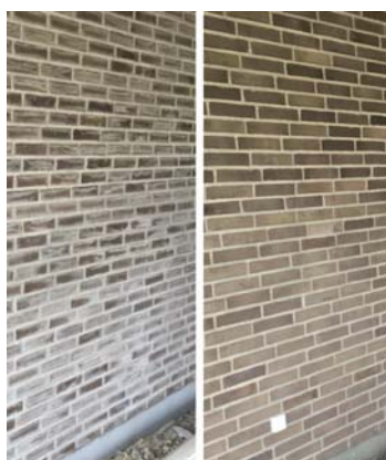
Efter opmuring fremkommer et slør på murstenen. Det er dette slør der traditionelt afrenses med saltsyre.
